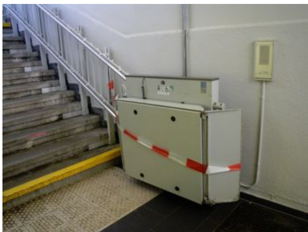
Schlecht für mobilitätseingeschränkte Personen: defekter Aufzug
