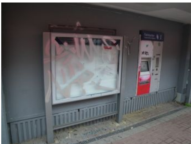
Beschädigung von Vitrinen, fehlende Aushänge und verschmutzter Automat
