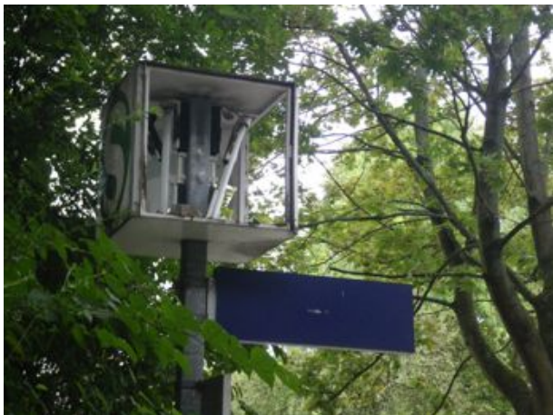
Beschädigungen der Beschilderung zum Bahnhof
