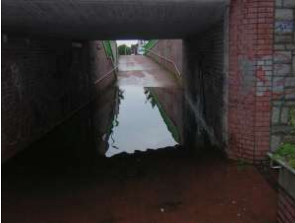
Die Bahnsteigunterführung am östlichen Bahnsteigende nach starken Regenfällen
