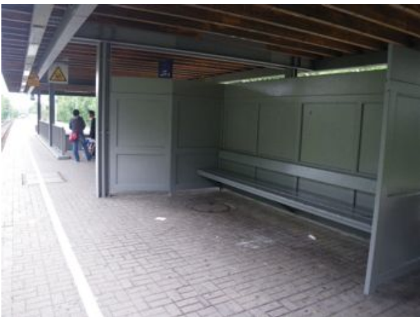
Sauber und unbeschädigt, aber schlecht einsehbar: Sitzbereiche auf dem Bahnsteig
