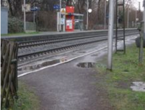
Nicht gepflasterter und zu schmaler Bahnsteig in Richtung Dortmund
