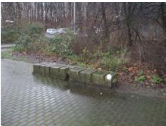
Bahnhofsumfeld (Müll etc.) und Fahrradständer befinden sich in einem schlechten Zustand
